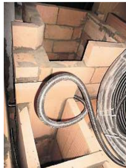
Silberne Schleifen sind im Ofen verlegt. In ihnen heizt sich das Wasser für die Heizung auf.
