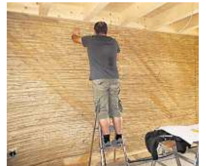
Auf die Vollholzwände haben Späths in den sechs Wochen der Sommerferien die Schilfbahnen für den Lehmputz getackert.
