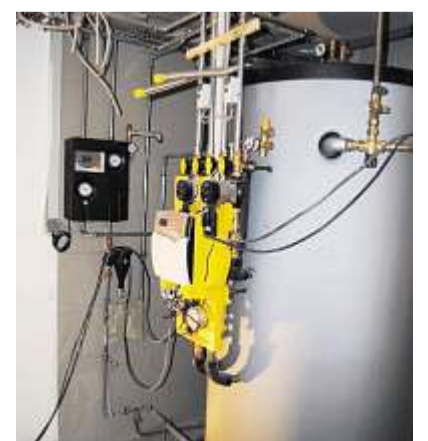
Sorgt für warmes Wasser: Der Speicher unter dem zentralen Holzofen, in dem das Wasser heiß wird.
