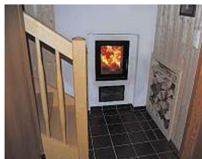
Die Wärmecelle: Mit dem Holzofen wird Haus und Wasser warm.
